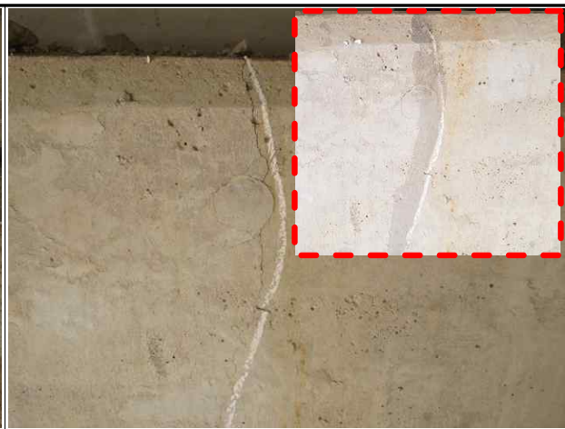
교대 A2 균열(폭0.3mm미만)(보수완료)
